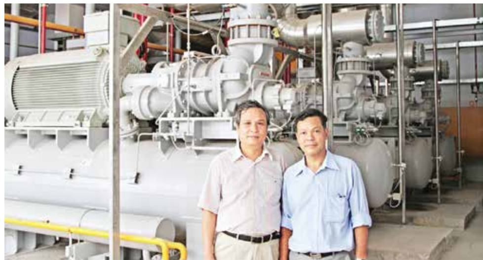
Hệ thống lạnh công suất 6000 Kw của nhà máy Sữa Mega - Vinamilk do POLYCO thiết kế, trang bị và lắp đặt.
